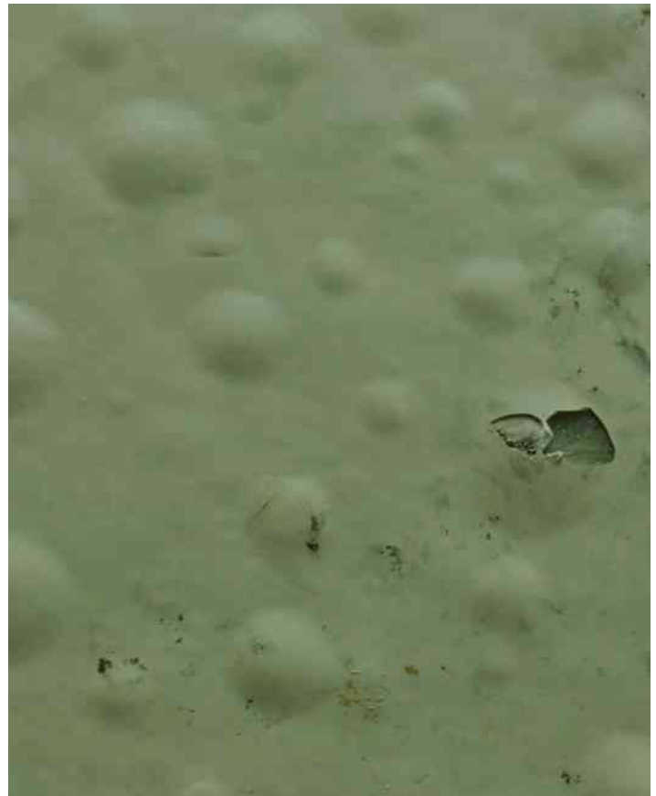
Figuur 30: Schade door osmose en hydrolyse: blaasvorming of blistering) (bron: RWS-GPO)
